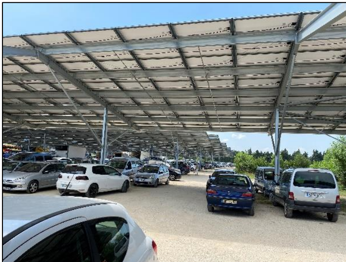
PARKEERPLAATSEN VOOR DE MARKT MET ZONNEPANELEN.
